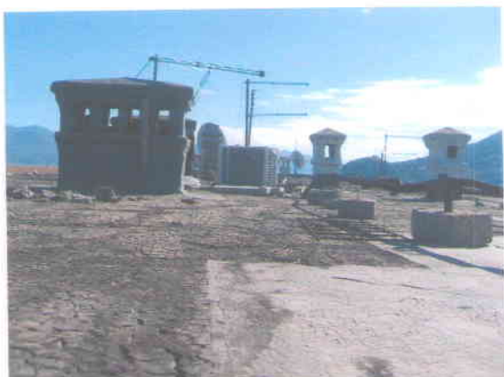
6. ravno neprohodno krovíšte
